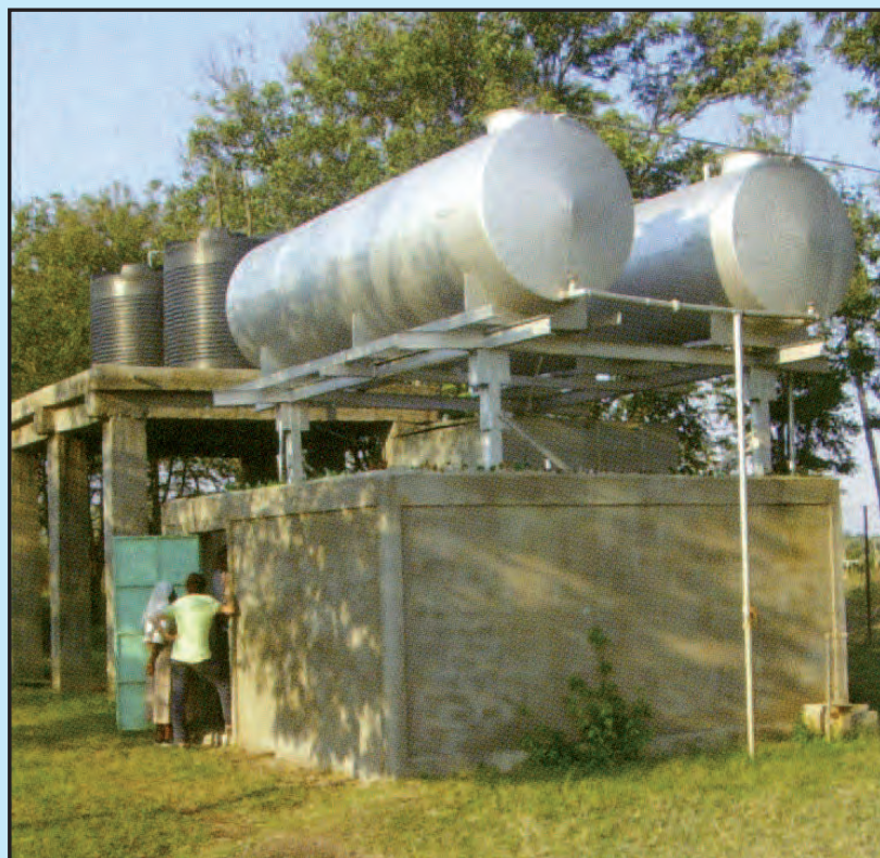
Karungu: impianto di potabilizzazione dell'acqua prelevata dal Lago Vittoria
