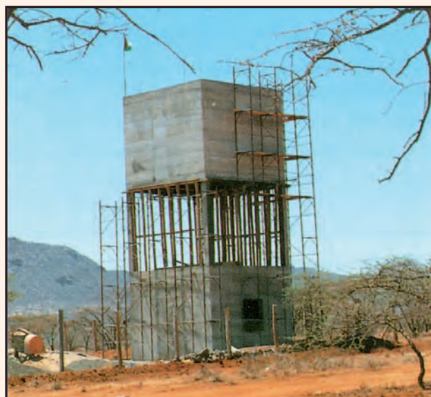
Campo di lavoro 1993: Il serbatoio pensile è pronto per i bambini della "Kipsing Academy"
